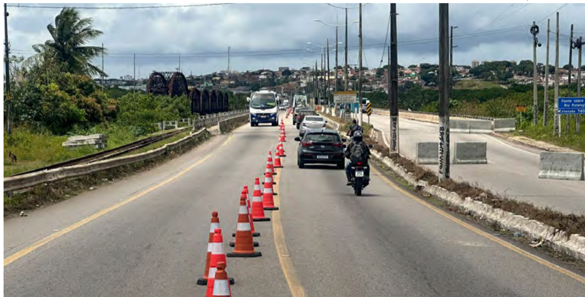
As obras foram iniciadas em setembro de 2023 e impactam o trânsito para a Zona Norte
