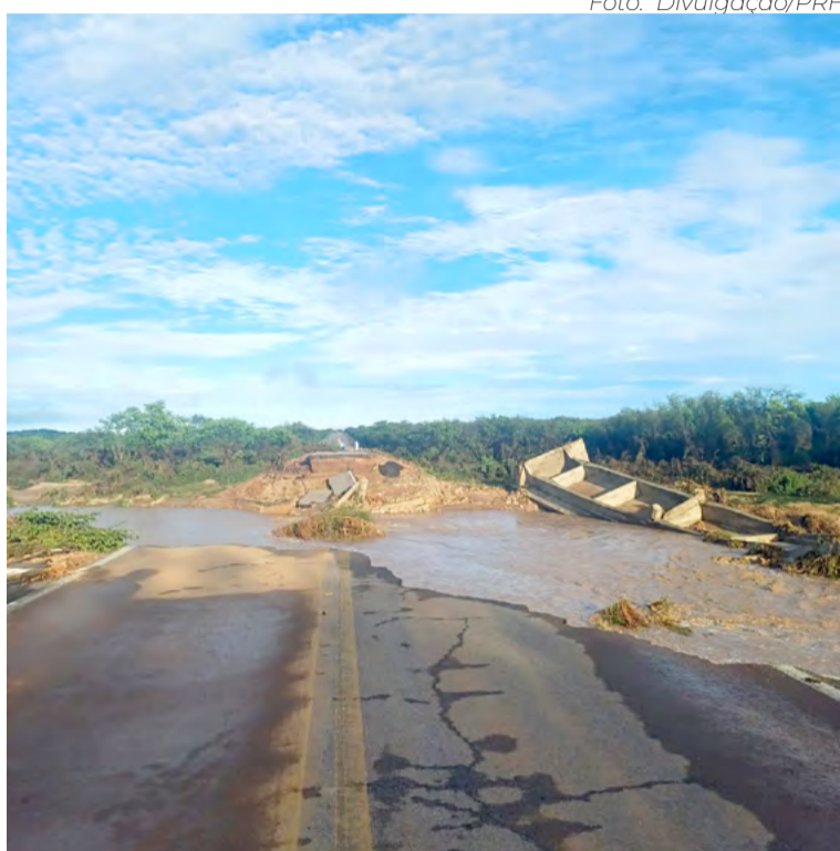
Ponte sobre o Rio Serra, em Lajes, desabou no domingo (31)
