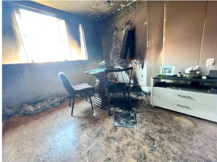
Incêndio atingiu residência da ex-prefeita Micarla de Sousa
