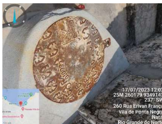
Figura 14: Caixa de “inspeção” feita para conter os transbordamentos. Fonte: NCC/IDEMA, 2023.
