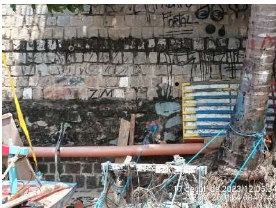
Figura 17: Trecho de tubulação de esgoto em frente ao muro de estabelecimento – sem ancoragem.
