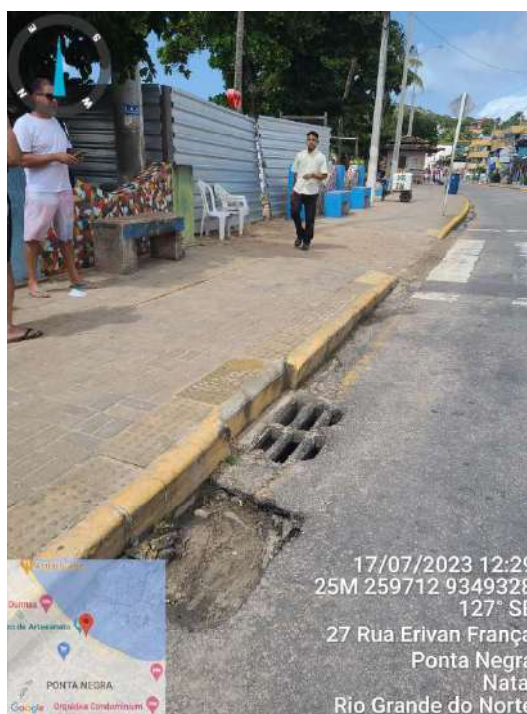
Figura 4: Boca de lobo referente ao dissipador nº 14. Fonte: NCC/IDEMA, 2023.
