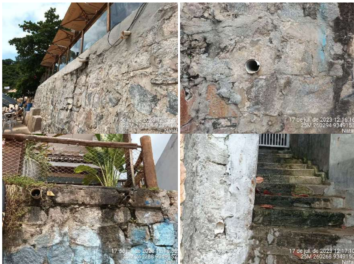
Figura 12: Tubulações de saída de águas pluviais de estabelecimentos para a praia. Fonte: NCC/IDEMA, 2023.
