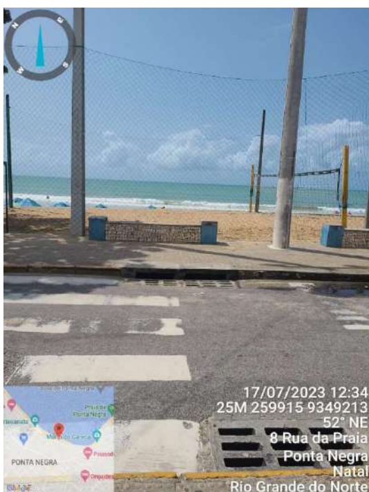
Figura 7: Bocas de lobo na Rua Erivan França. Fonte: NCC/IDEMA, 2023.
