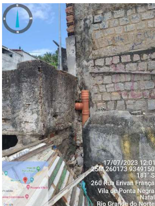
Figura 15: Tubulação de saída da caixa de “inspeção” – segue para a rede de coleta da Rua Erivan França. Fonte: NCC/IDEMA, 2023.
