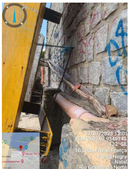
Figura 16: Trecho de tubulação de esgoto em frente ao muro de estabelecimento – com ancoragem. Fonte: NCC/IDEMA, 2023.
