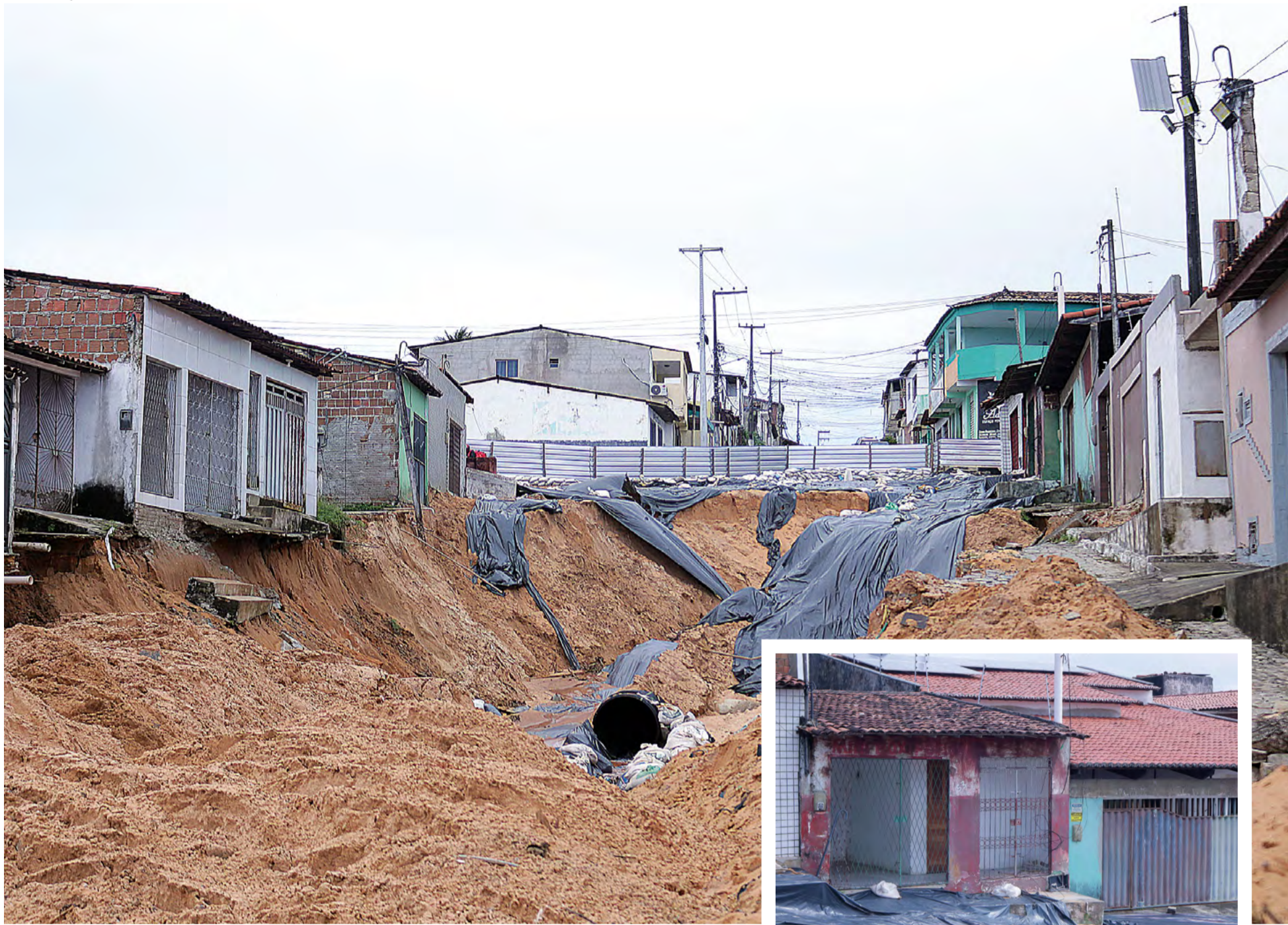
Cratera foi aberta após fortes chuvas em julho passado. Recuperação custou R$ 3 mi
