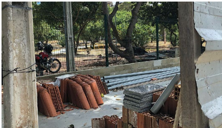
Por trás dos tapumes, há restos de material espalhados
